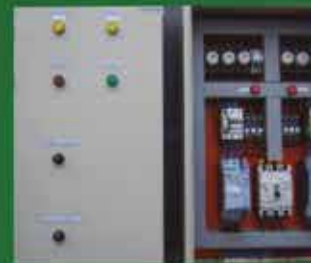
QUADRO ELÉTRICO DE BOMBAS
