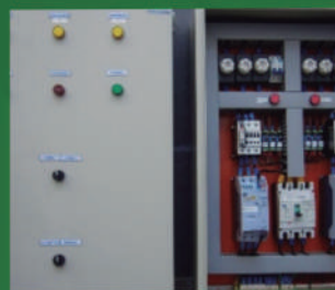
QUADRO ELÉTRICO DE BOMBAS
